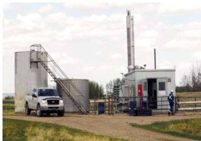
Gasförderanlage der erworbenen Quellen in Bashaw
