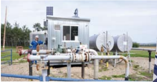
Die Pipelines in Medicine River führen zur abgebildeten Anlage, die das ankommende Gas von Wasser und Kondensat befreit
